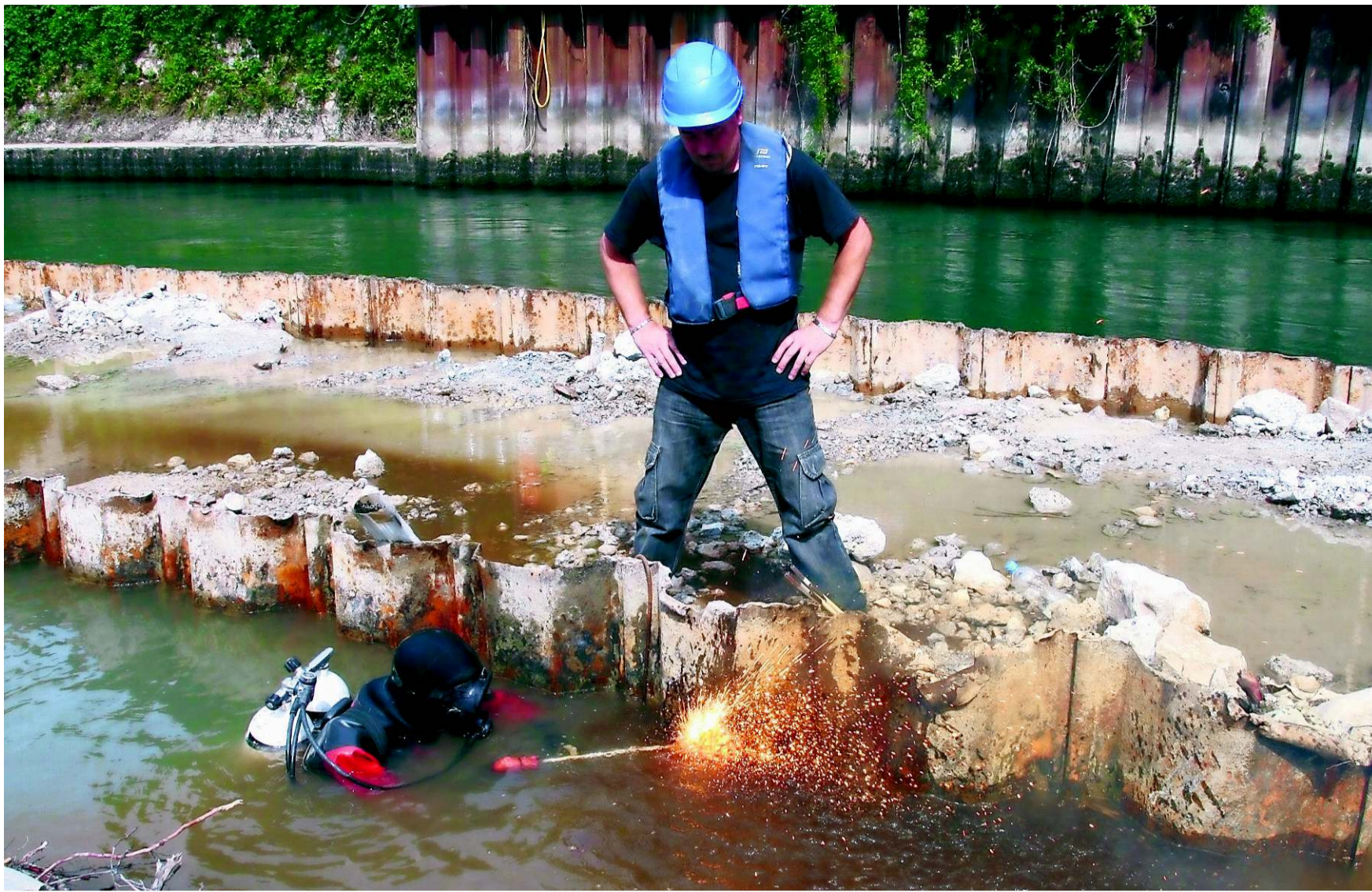
Arbeitstaucher David Wiederkehr bei Schneidarbeiten an der alten Wehrmauer in der Limmat beim Badener Kraftwerk Aue.
